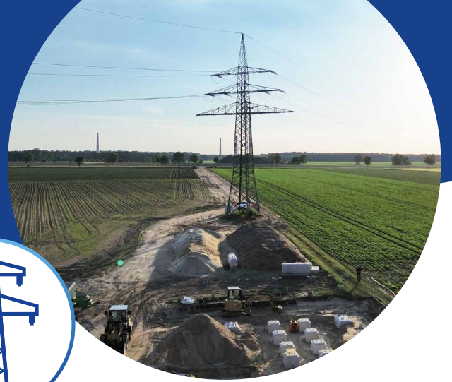
Transformer substation Hansen (Klein Süstedt)
